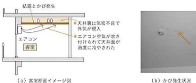
図1 天井材に発生したかび
